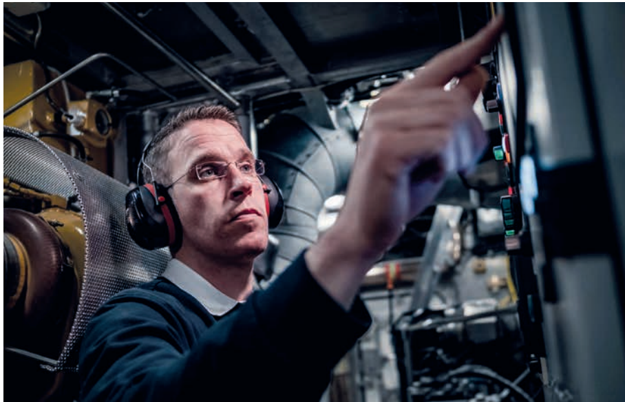
Über die Knöpfe und Schalter der Schalttafel steuert, kontrolliert und bedient Christopher Kölln alle Funktionen.
